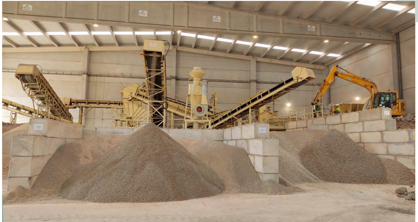
■ Waste recovery plant (Sant Vicenç dels Horts, Spain)
